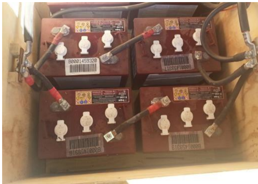
FIGURA 29: CONEXIONADO DE BATERÍAS ABIERTAS (R.VALDOVINOS)
