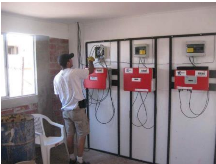
FIGURA 32: INSTALACIÓN DE TRES INVERSORES ON GRID EN COMBARBALÁ (R. VALDOVINOS)
