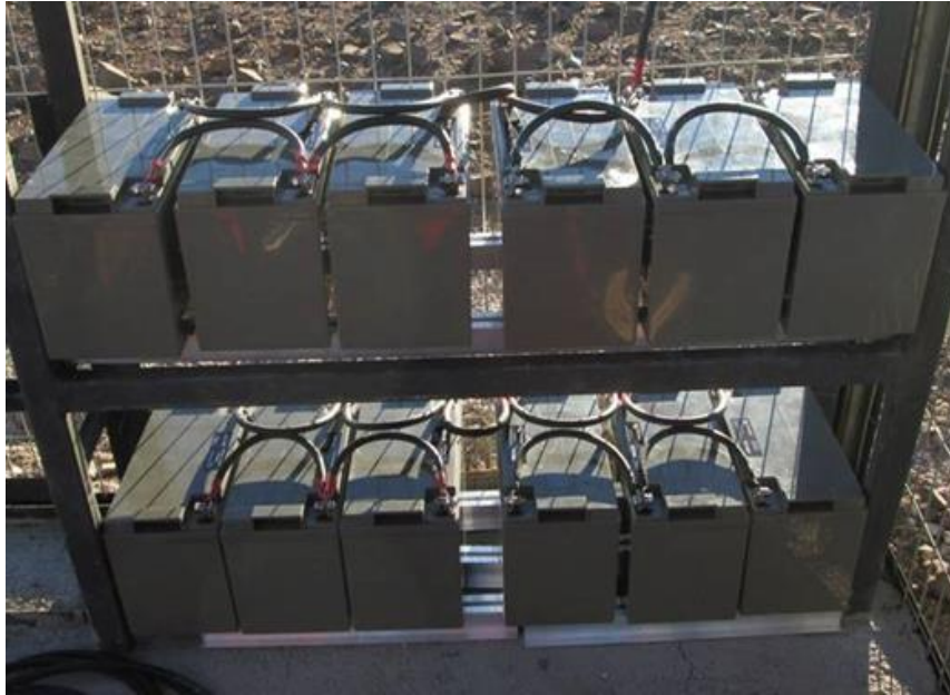
FIGURA 30: CONEXIONADO DE BATERÍAS SELLADAS (B. MUNIZAGA)
