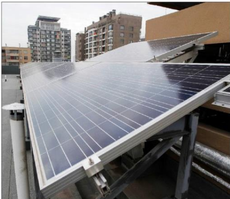
Este edificio de inmobiliaria Fundamenta tiene 40 paneles solares.
